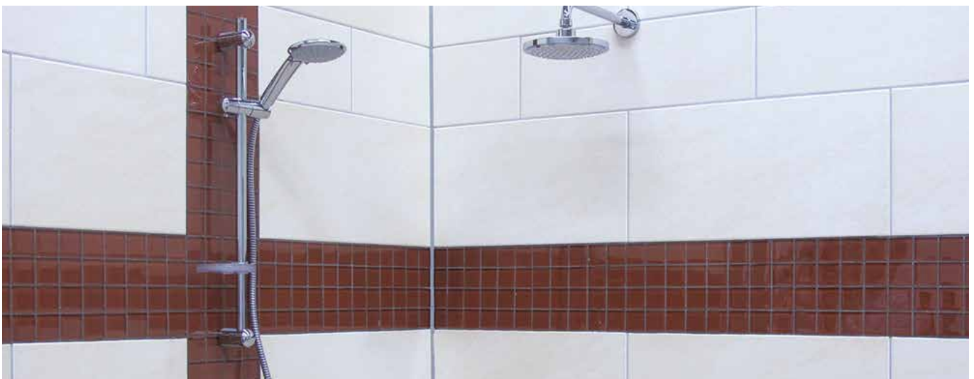
11 Farbbrillante Fugenflächen im Badezimmer.
